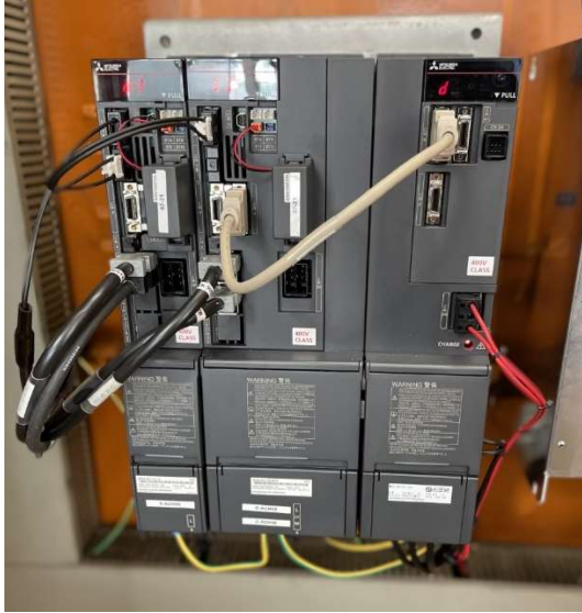
Bild 3: Neue Antriebe von Mitsubishi Electric in dem alten Schaltschrank der Außenrundscheifmaschine der Firma Schleiftechnik Witt
